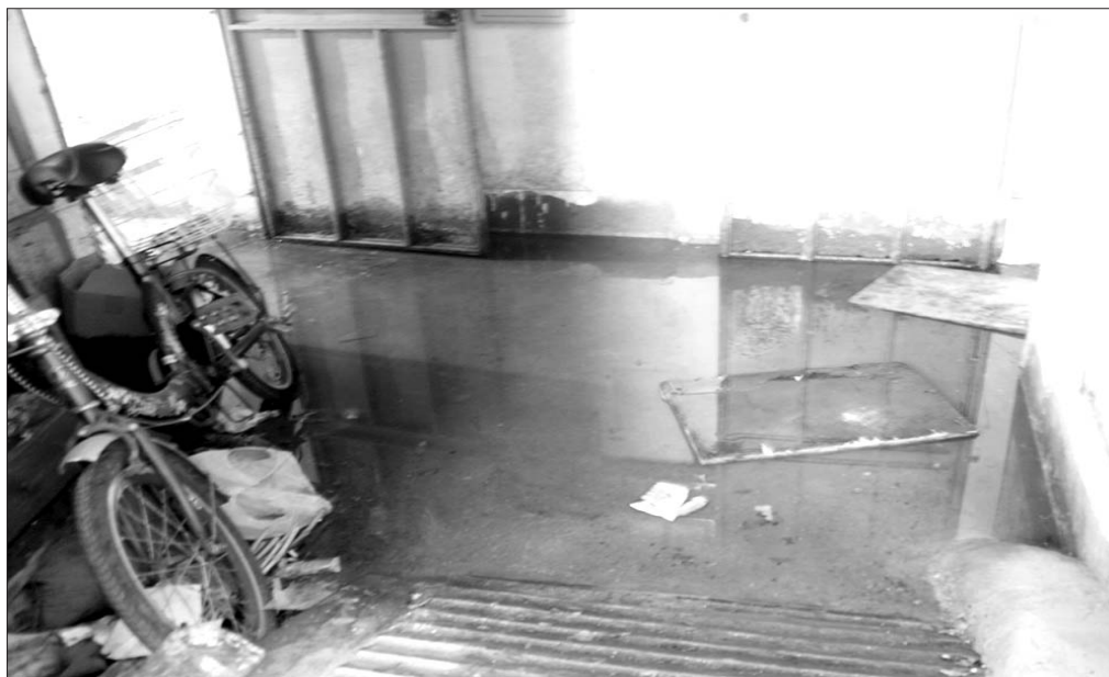
邵女士家的地下室被水浸泡。 本报记者
