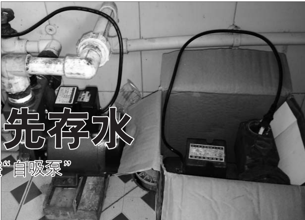
佳元小区一住户已经用坏了一个自吸泵，刚刚安装了一个新的。
