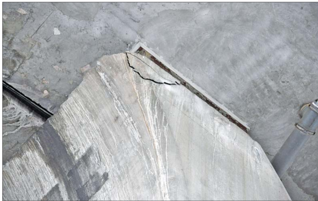
全福立交桥一个桥墩顶部边缘出现裂缝,有水泥脱落迹象。本报记者任志方摄
