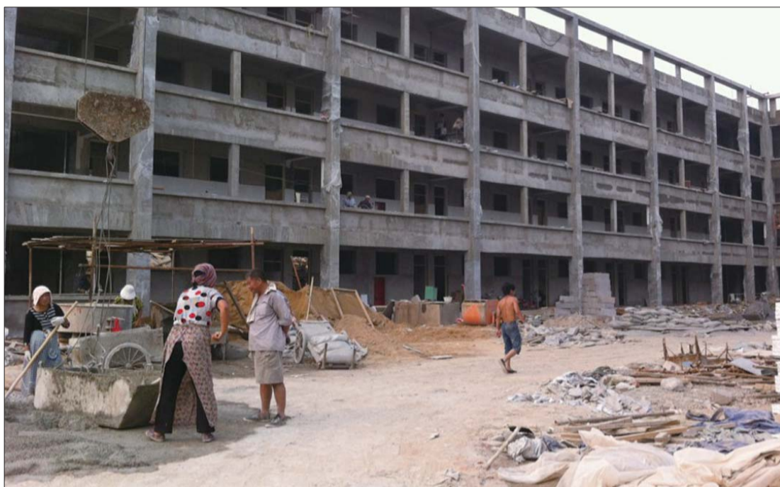
城区怡景小学正在施工,教学楼已经封顶,工人正在装修。 本报记者 陈洋洋 摄
