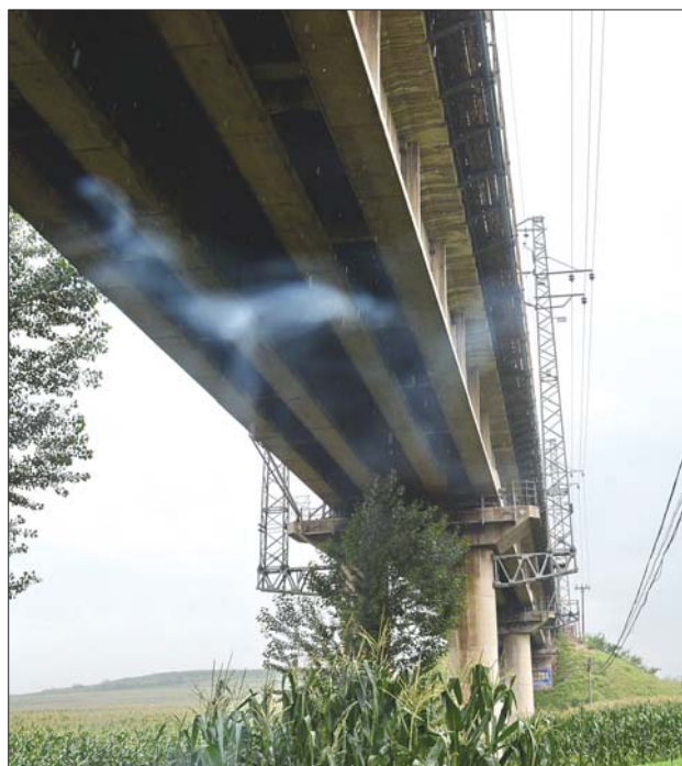
这是发生事故的迷雾河铁路特大桥。 新华社发
