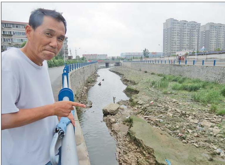
河床塌陷,出现大坑,市民担心河道安全。 本报见习记者 张文 摄
