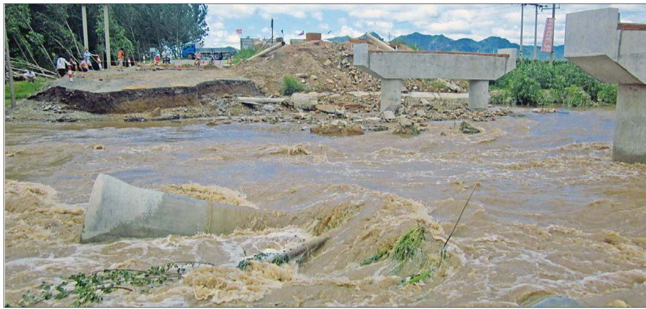
连日的大雨过后,迷雾河水流湍急浑浊,便道的断裂处清晰可见。
