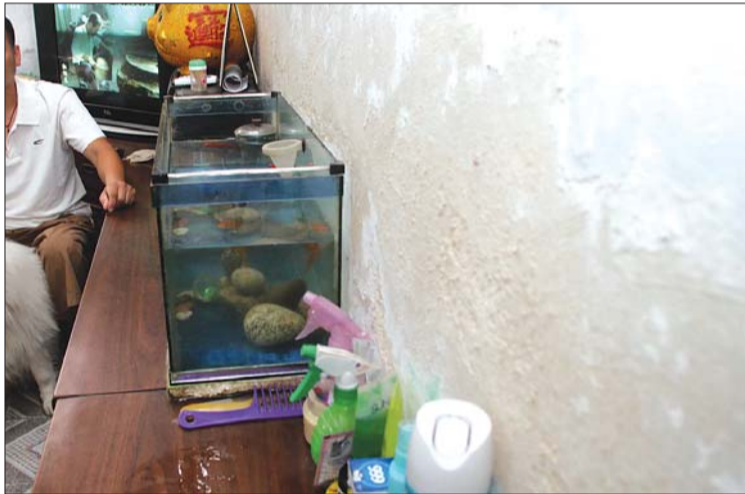
一楼居民家的墙皮发霉脱落。
