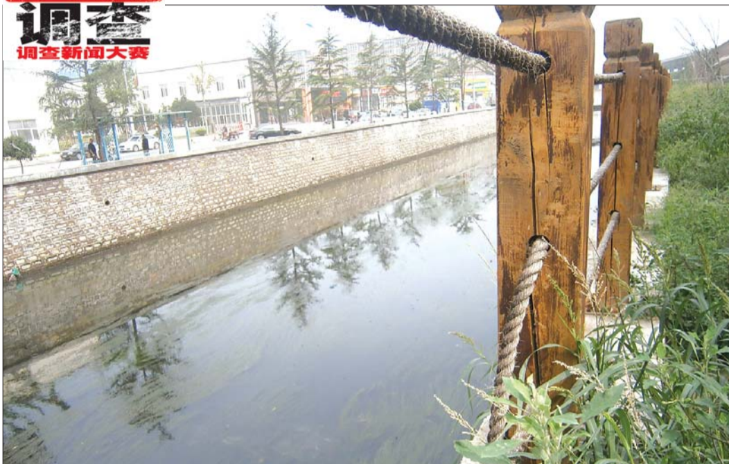
部分麻绳已经断掉,存在不小的安全隐患。 见习记者 宋立山 摄
