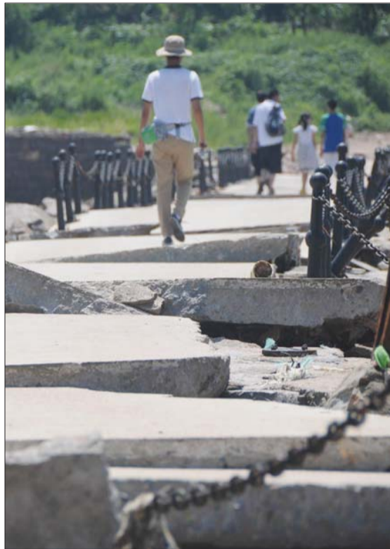
受台风“达维”影响,通往小麦岛的漫水坝损毁严重。 本报记者 张晓鹏 摄
