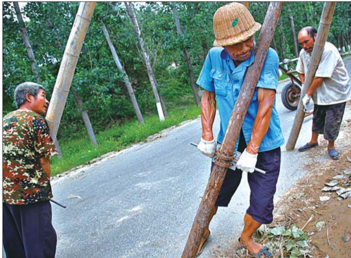
4日下午4点左右,日照供电公司的抢修人员,在东港区南湖镇架设新的电线杆。杆底抢修人员正在用铁杆将电线杆顶起。
