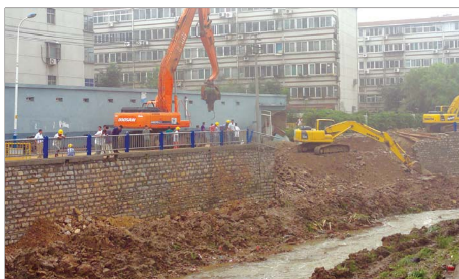
▲施工工人正在对坍塌的河堤进行维修加固。 本报记者 张泰来 摄
