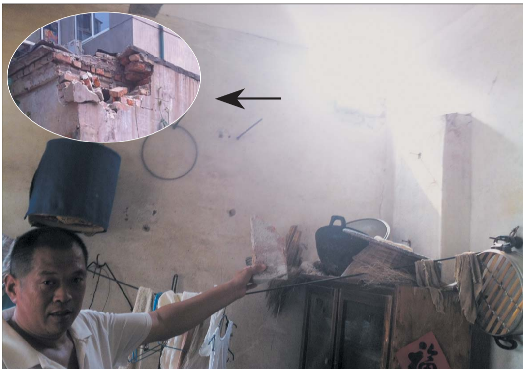
被挖掘机撞出大洞的屋顶。 本报记者 王尚磊 摄
