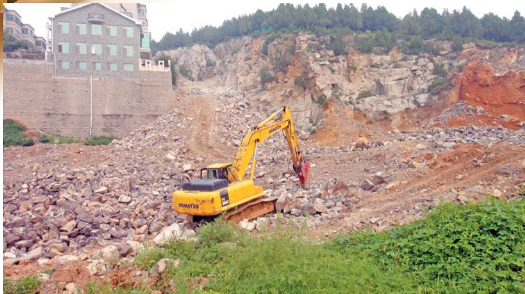
▲8月8日下午,一辆挖掘机正在龟山下施工作业。 实习生 朱晓宇 摄
