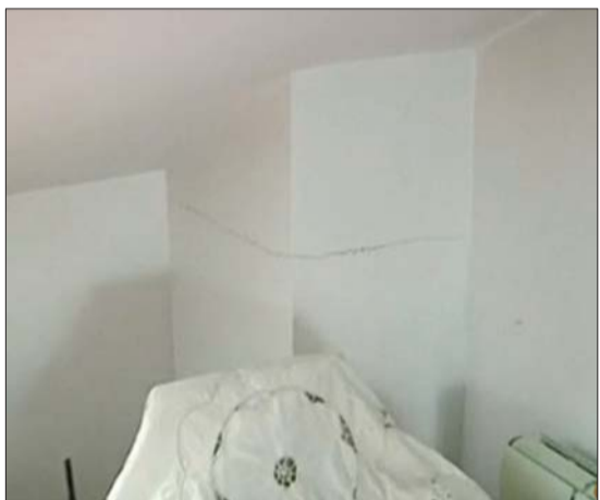
图为王女士家中屋顶被震裂的影像截图。
