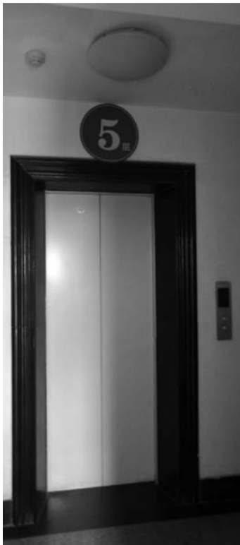
已经停运的电梯。
