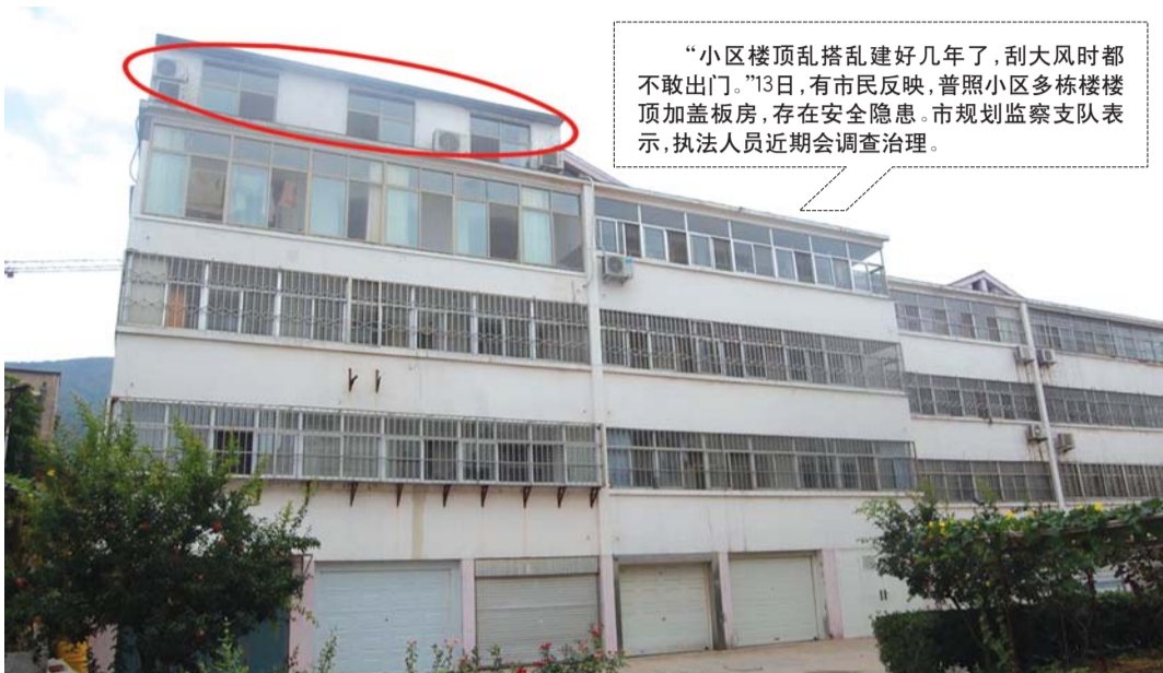
一栋三层的居民楼,有住户在楼顶搭建板房。
