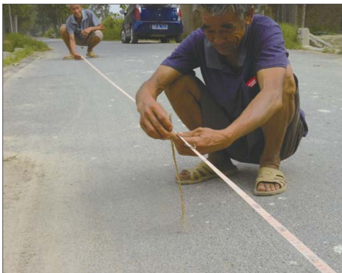
▲细心的村民测量桥面下沉的幅度。
