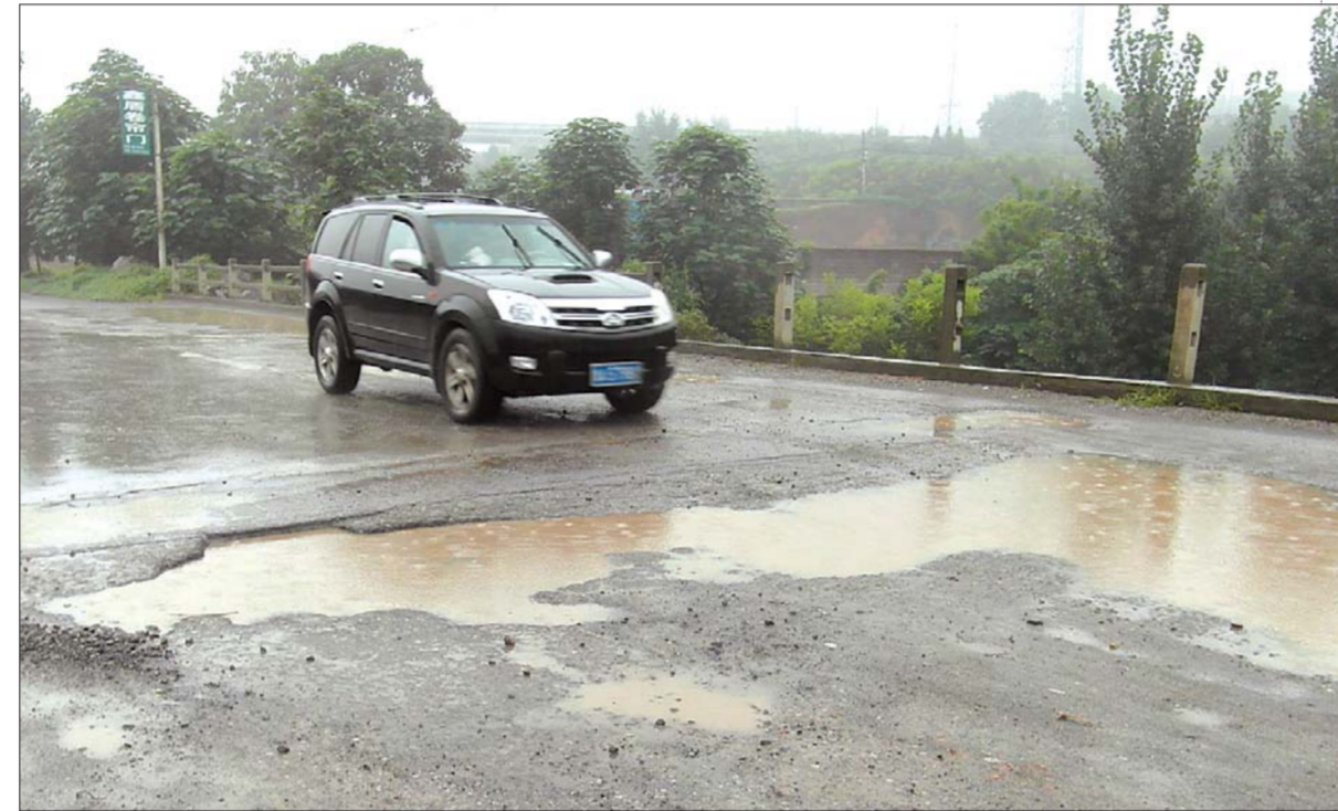
港西路上坑洼不平下雨容易积水,过往车辆遇到深坑经常触底盘。本报记者 张嶺 摄
