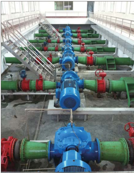
东郊水厂里的供水设备。 本报记者 刘铭 摄
