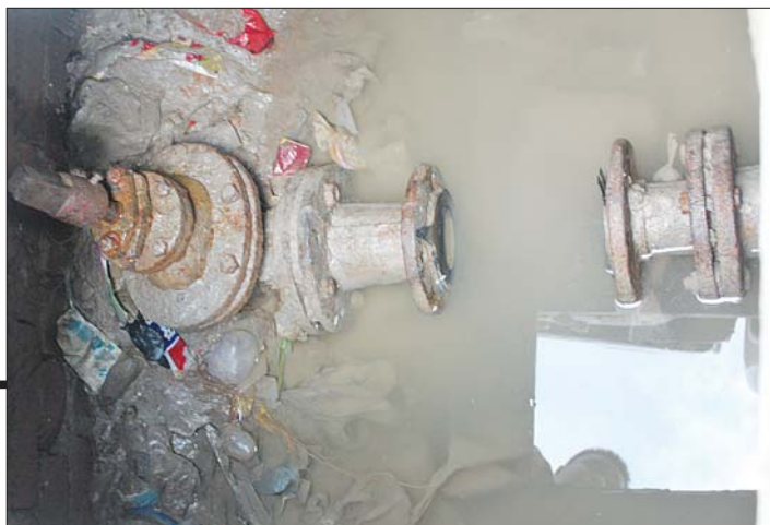
▶小区供水总水表被摘走,小区陷入停水。
