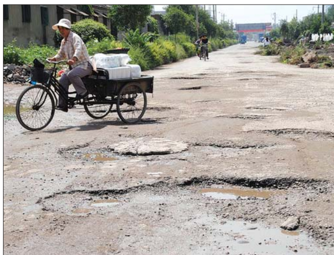
芙蓉路上大小坑几十个,居民出行不便。本报记者 赵兴超 摄
