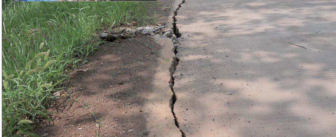
一家石膏粉厂的厂房因为地面塌陷已经严重变形(小图)。塌陷区的马路上能看到很大的裂缝(大图)。本报记者 李淼 摄
