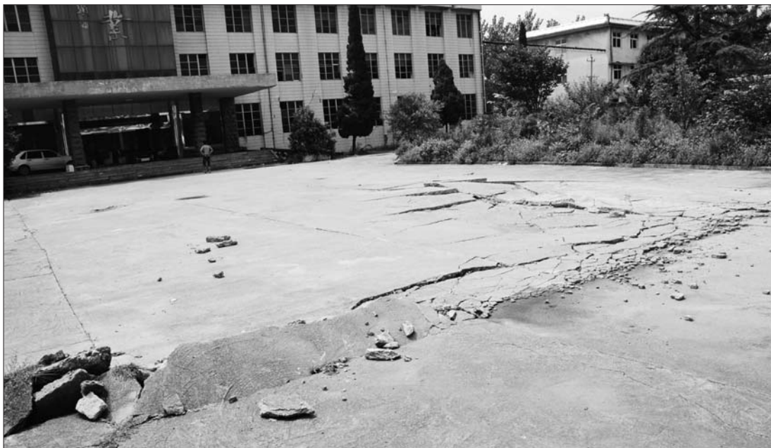
路面现裂缝,坑洼不平。
