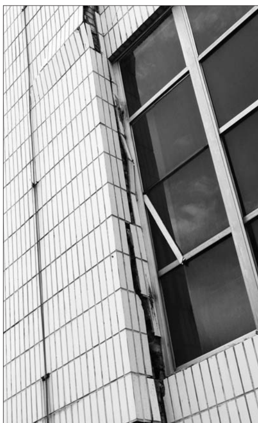
一楼房外墙受损。
