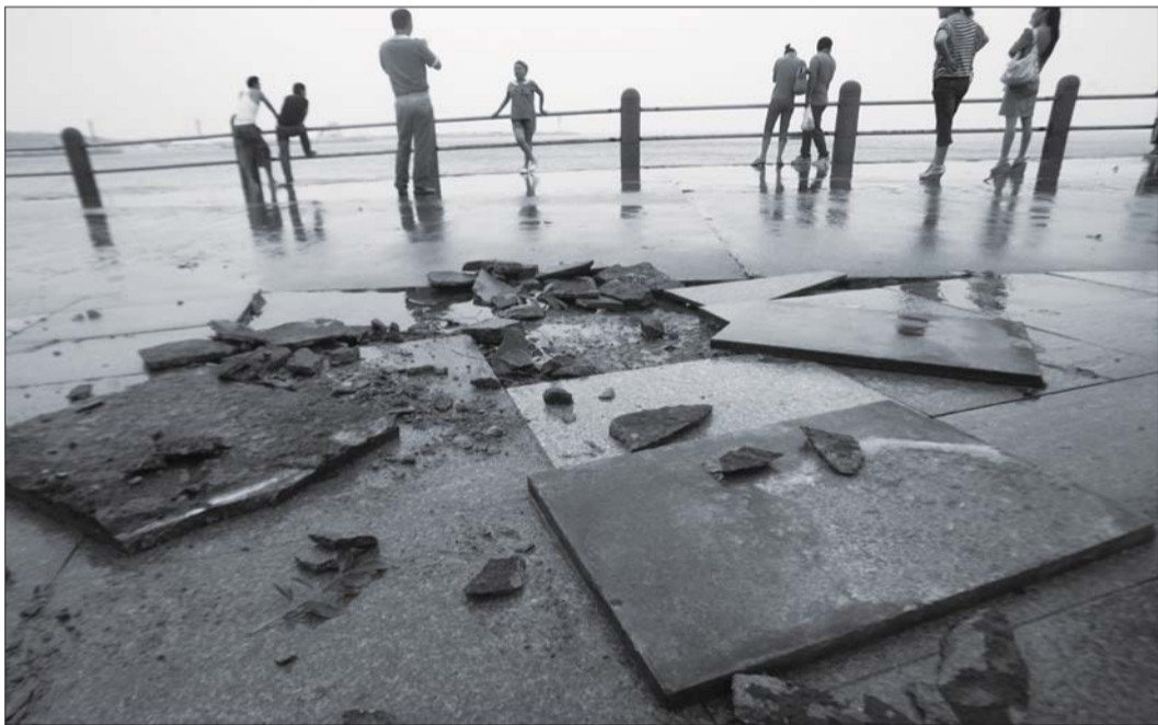
沿海的地砖被打碎。张晓鹏 摄
