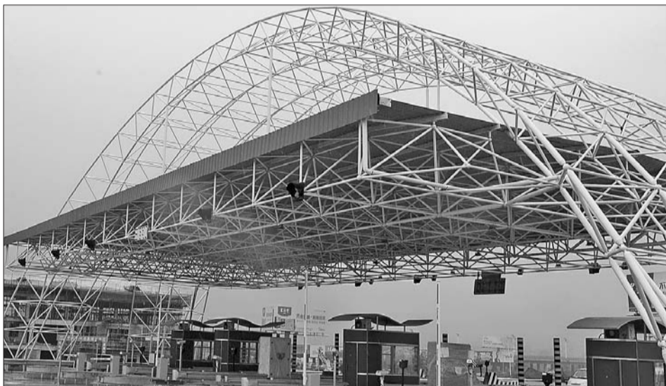
9月6日,济南绕城高速济南南收费站扩建部分主体完工,正在进行最后的设备安装,将在国庆节前夕启用。济南南收费站车道将扩为六进八出。 本报记者 周青先 摄
