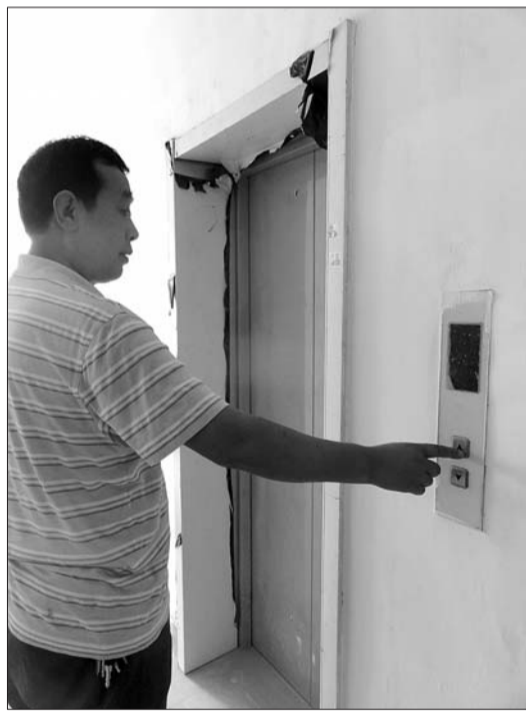
馨苑小区10号楼两部电梯有一部不能用。本报记者 王倩 摄
