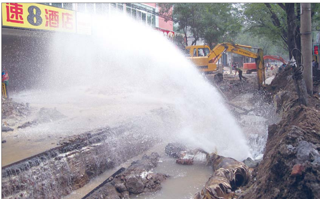
受损供水管道喷出5米多高的水柱。路帅 摄
