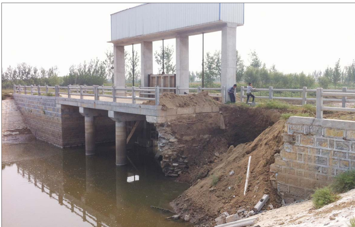
15日中午,位于高唐县梁村镇朱楼村附近的沙河沟水闸桥,突然发生垮塌事故,导致行人无法通过,而该桥建了还不到一年半。记者注意到,发生垮塌的桥体里面全是泥土,竟然没有水泥砂石。图为塌桥现场。本报记者 刘铭 摄 >>>C03
