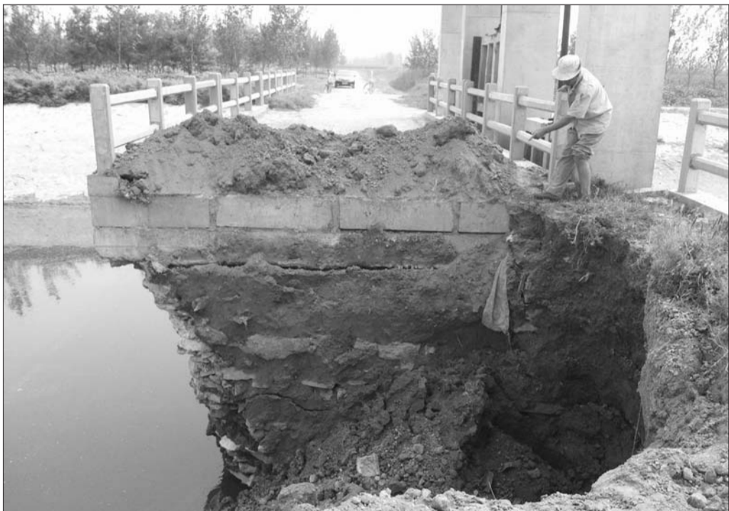
发生坍塌的桥体里竟然没有水泥和砂石。
