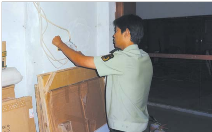
17日下午,龙口市消防大队防火监督员在对辖区单位进行消防安全隐患排查时,对存在严重消防安全隐患的龙口市某家具商城进行了临时查封。据悉,该家具城室内装修采用可燃材料,且室内缺少灭火器、应急照明灯等,电气线路也未按要求敷设。 通讯员 吕宗峰 记者 苑菲菲 摄影报道
