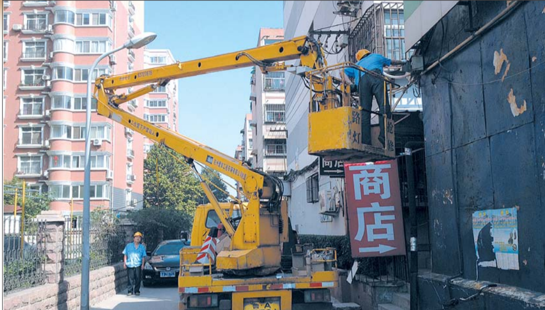
路灯管理处工作人员在检查铁路桥附近的路灯电脑控制箱。 见习记者 陈熹 摄
