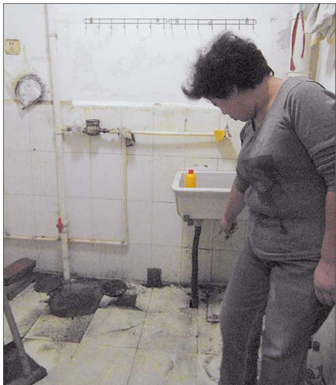
溢出的污水刚刚排完,地上还残留了不少污泥。
