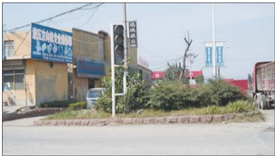
东西方向的信号灯也已经损毁,防护罩脱落。 本报记者 李焱 摄
