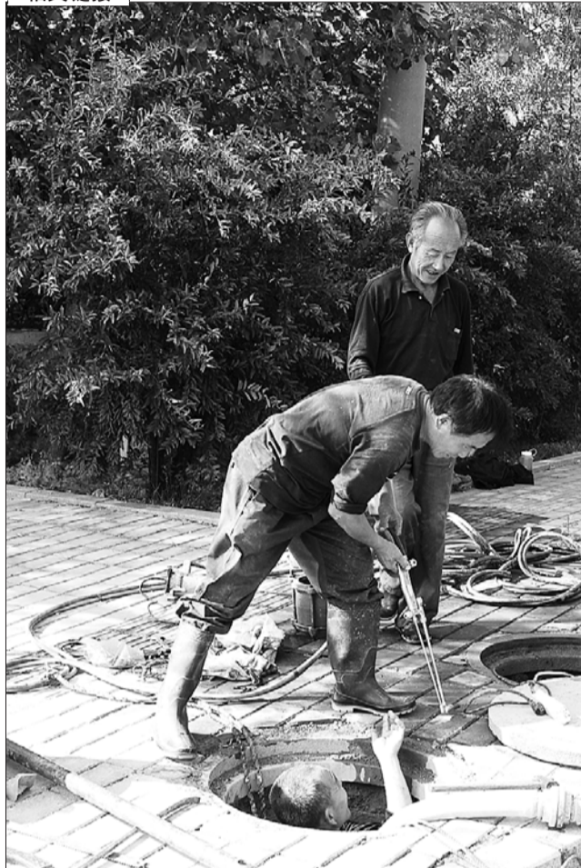
19日下午,辽河路上,工作人员正在更换新的自来水管阀门。据介绍,之前的管道阀门已经陈旧,换上新阀门后可以更好地保证饮用水的供给。 本报记者 任小杰 摄影报道
