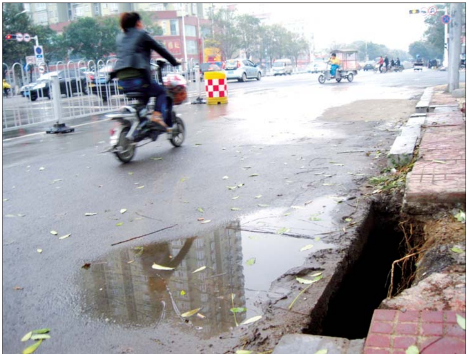
一位市民骑电动车从路基塌陷的路面驶过。王洪磊 摄
