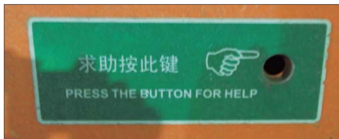
开元隧道内部分消防报警器丢失,部分紧急求助键被抠掉。
