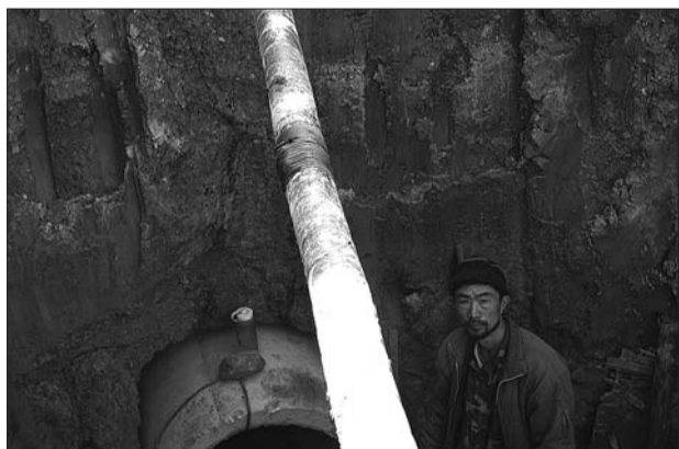
23日上午11点,在一施工现场,一处电缆被挖伤。
