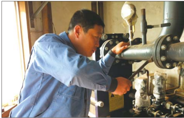
工作人员正在旺海花园换热站进行新装机组调试工作。
