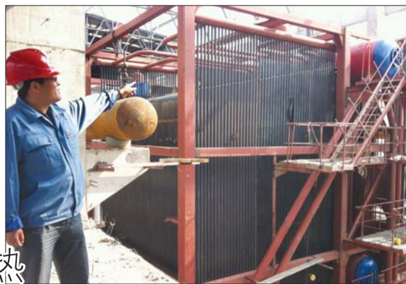
社会福利院供热站新安装的高温水锅炉。
