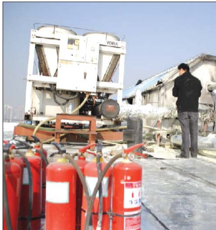
管道外围的保温材料被烧毁,用了十几个灭火器才把火扑灭。本报记者 赵兴起 摄
