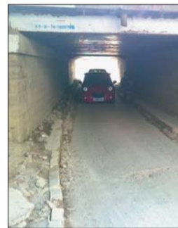
铁路桥下路面坑洼难行,附近市民期盼修缮。
