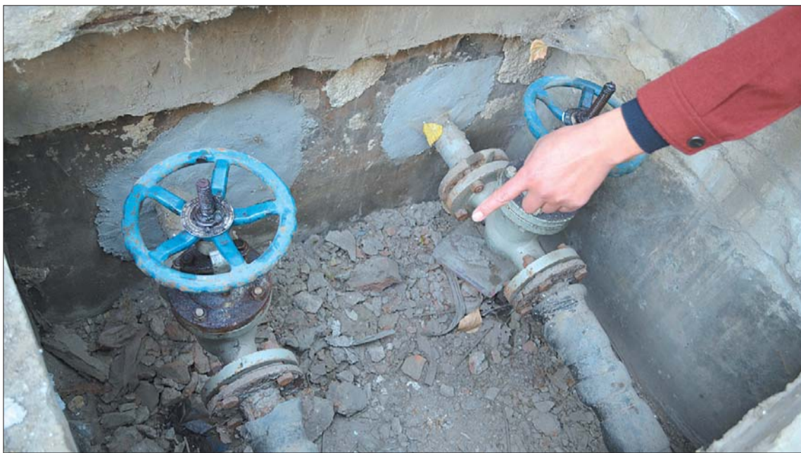
居民单元楼前的单元阀不少都已经锈蚀。 本报记者 王光营 摄
