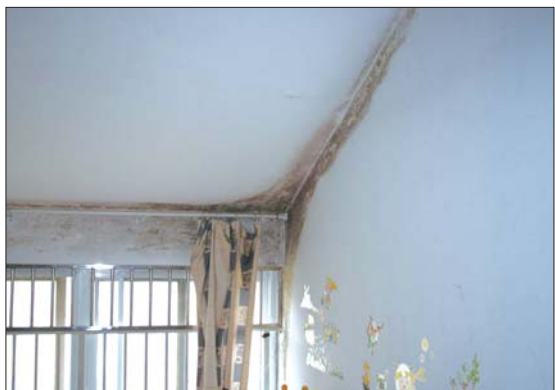
顶层房屋墙面渗水后发霉变黑。
