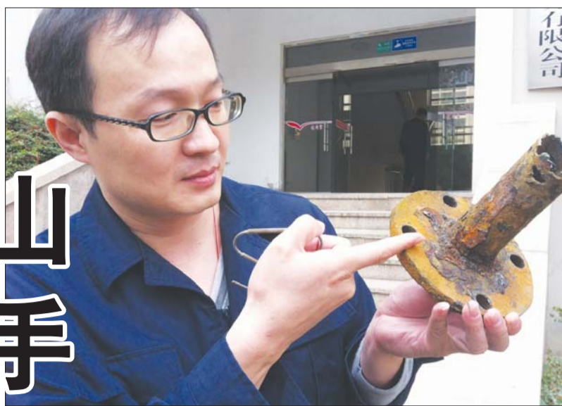
工作人员展示部分锈蚀的管道。
