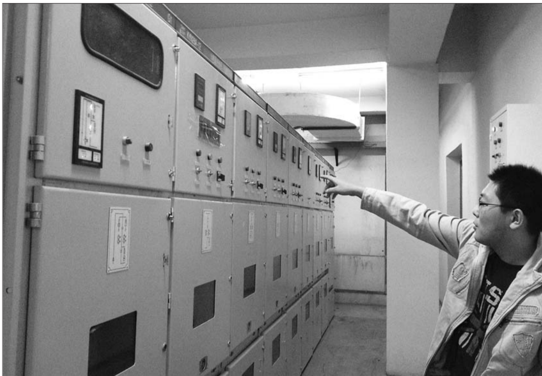
物业公司负责人介绍配电室里两条电路设备。
