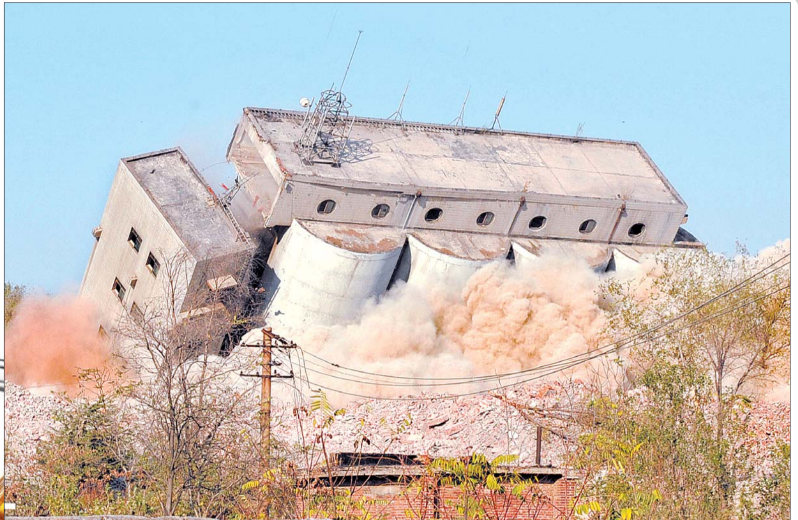
30日15时18分,随着一声巨响,有着31年历史的白马山啤酒厂8个麦芽仓被爆破拆除。 本报记者 张中 摄
