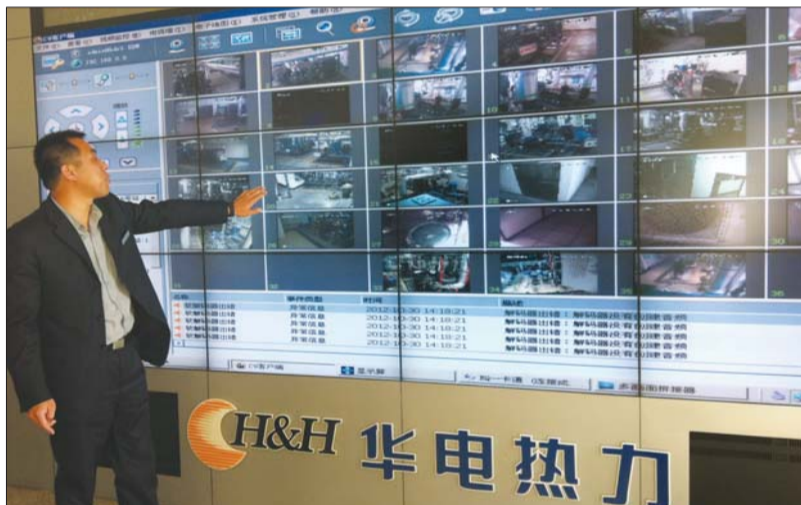
华电热力数字化智能监控系统能显示各换热站实时情况。
