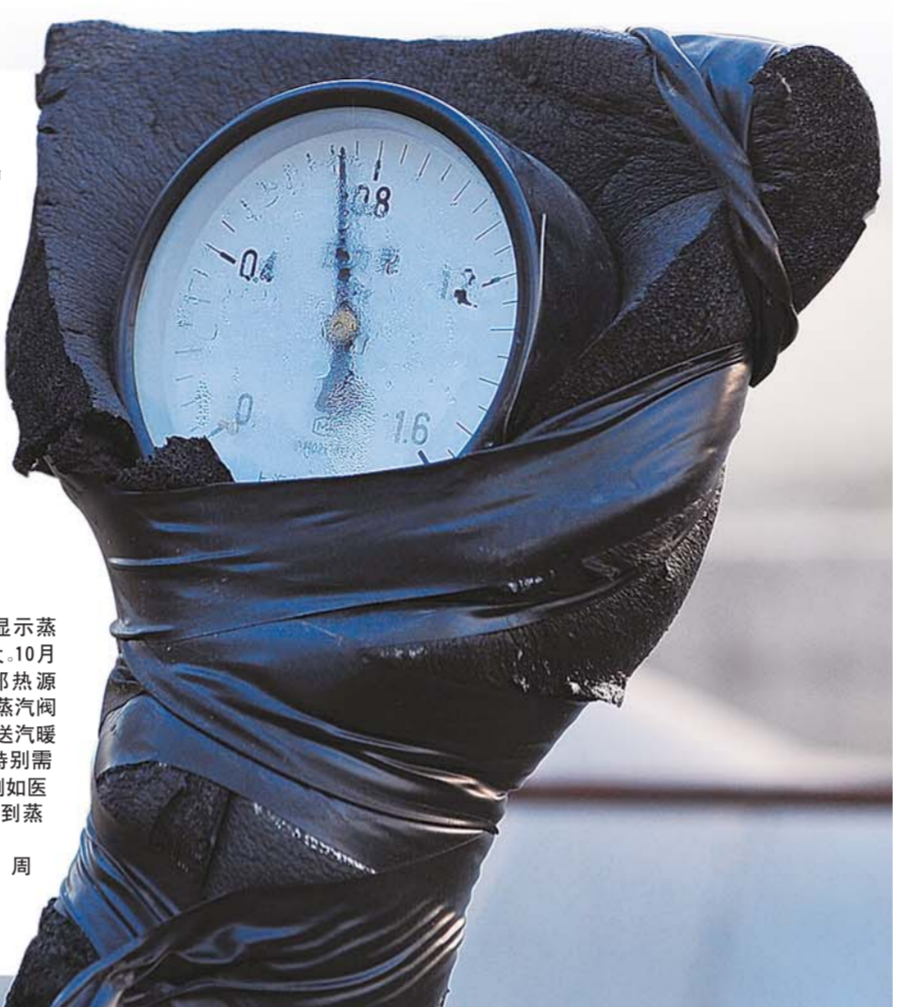
压力表示蒸汽压力开始增大
