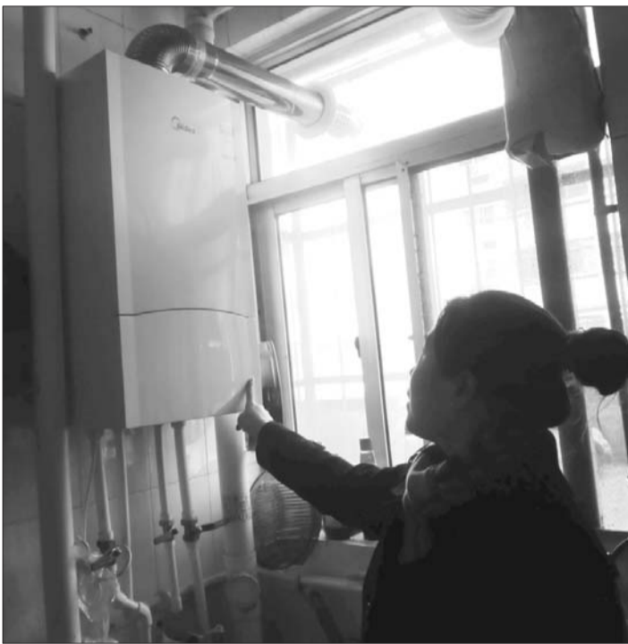
王女士家厨房里挂着的燃气壁挂炉,上面留有天然气接口。
