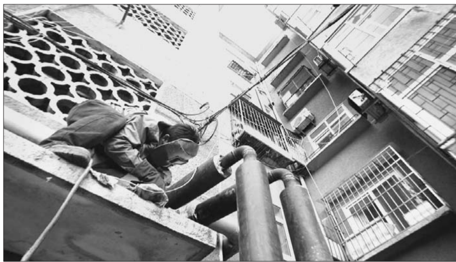
热公司正在进行供暖管道入户段的最后安装调试。 张晓鹏 摄
